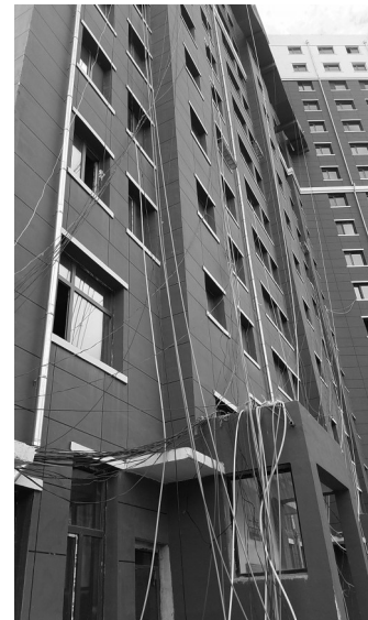
小区住宅楼外电线水管密布,居民戏称“盘丝洞”。 辽沈晚报、聊沈客户端特派朝阳记者 崔晋涛 摄
